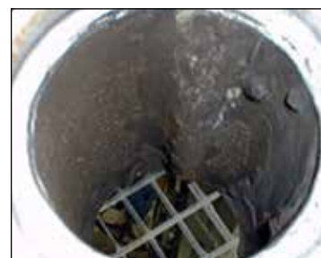
Magrör med vakuumskada (veck)
