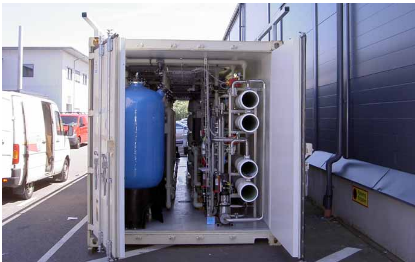
Ett komplett färdigställt vattenverket monterades in i en isolerad, luftkonditionerad container, designad för att kunna stå ute i solen och värmen i Irak.
