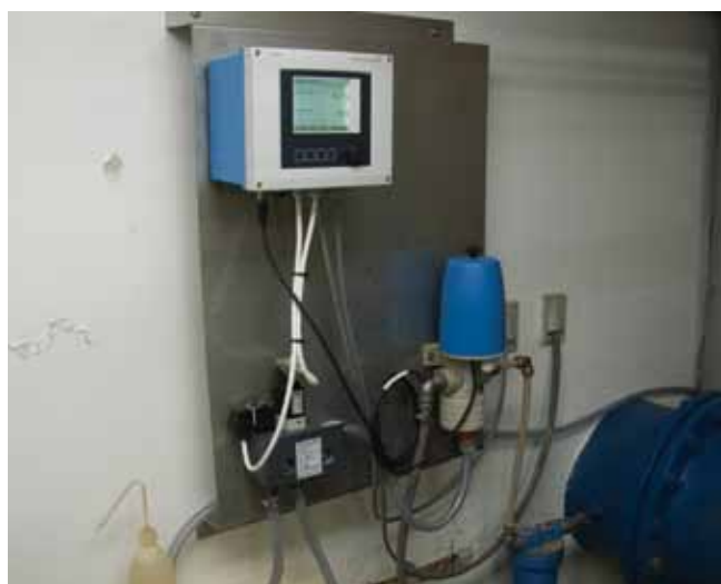
Anläggningen som den ser ut vid inloppet från brunnarna vid vattenverket i Varde. Här mäts pH och resultatet skickas direkt via en Liquiline-transmittter till kontrollrummet.
