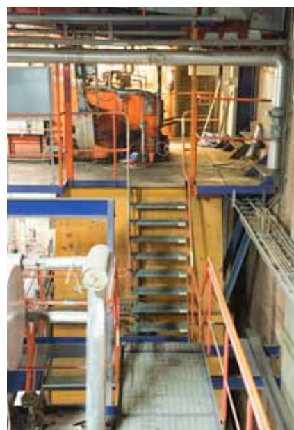
Att ha kontroll på nivån av träflis i biosilon vid värmekraftverk är viktigt för verksamheten. Nivågivaren Micropilot FMR57 är placerad i överdelen av silon.
