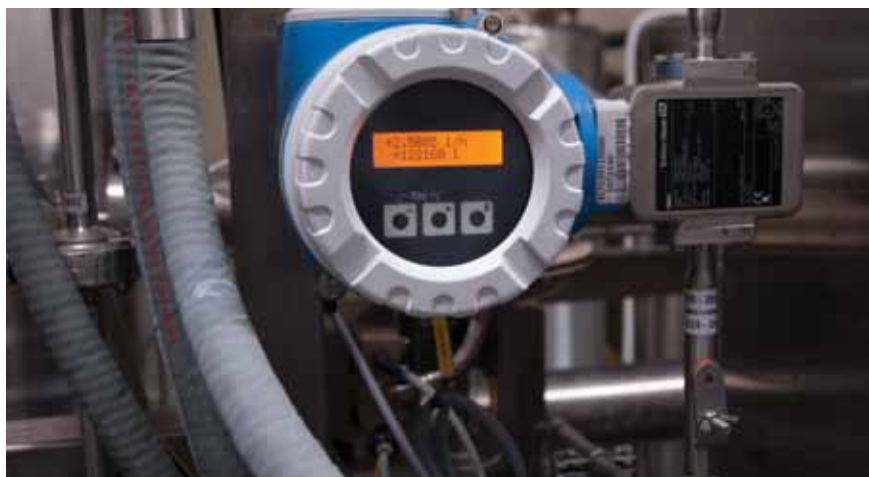
En av de två Promag 50H flödesmätare som har levererats av Endress+Hauser till anläggningen i Foulum utanför Viborg.
